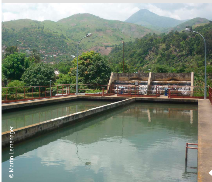
Vue sur la station de traitement d'eau potable d'Uvira
