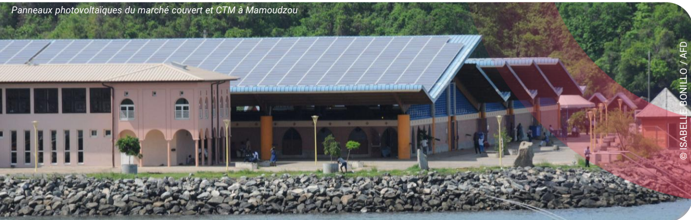
Panneaux photovoltaïques du marché couvert et CTM à Mamoudzou
